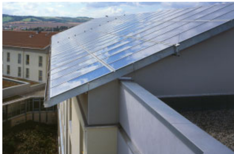
Thermie Großanlage auf dem Dach einer Rehaklinik erwärmt Trinkwasser, Heizung und Schwimmbad
