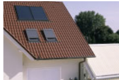
Einfamilienhaus mit thermischer Solaranlage zur Warmwasserbereitung
